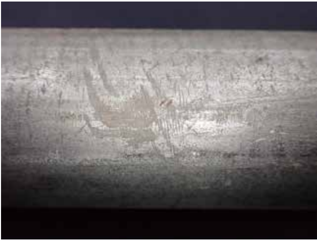
カラー図 18 鋼管表面の擦り傷またはひっかき傷の例（鋼管A）
